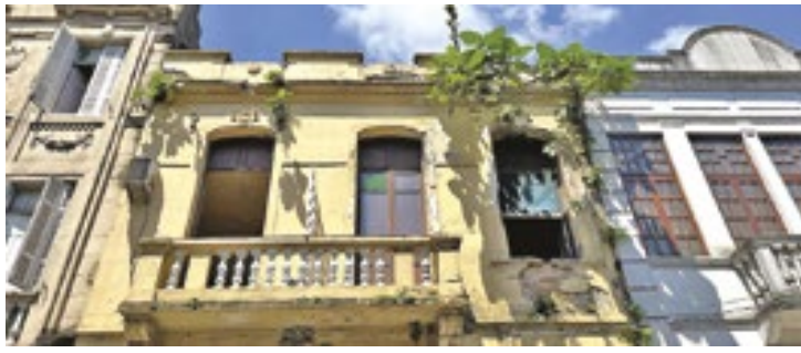
Raízes podem comprometer marquises e fachadas, colocando em perigo tanto pedestres quanto a integridade das construções
