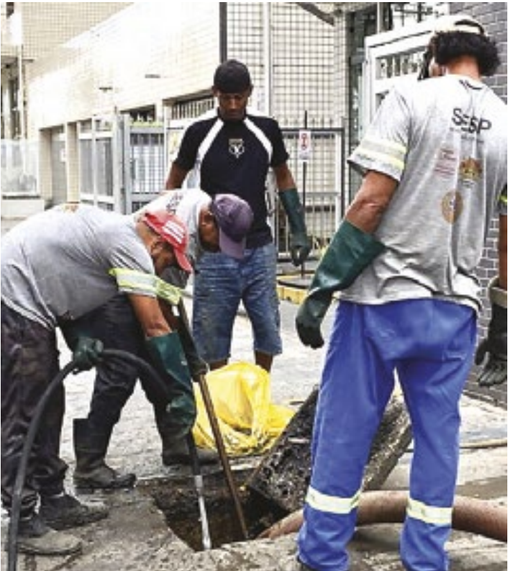
A técnica foi aplicada ao longo da Avenida Presidente Wilson, com foco na identificação de falhas no escoamento de efluentes
